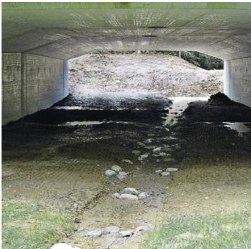
Die Wildtierunterführungen an der Mellingerstrasse und im Raum Grossholz (A1).
