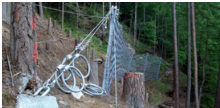
Opere di protezione moderne contro la caduta di sassi, realizzate sopra la stazione ferroviaria di Poschiavo
